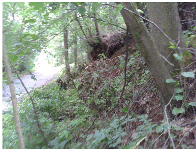
Fot. 4. System korzeniowy drzewa prawie całkowicie odsłonięty leży na skarpie o nachyleniu 1:1.
