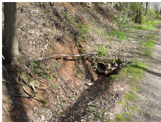
Fot. 6. Widoczny przepust D - 300 mm PHD z ujściem wody do rowu. Widoczne drzewo z odsłoniętym systemem korzeniowym.
