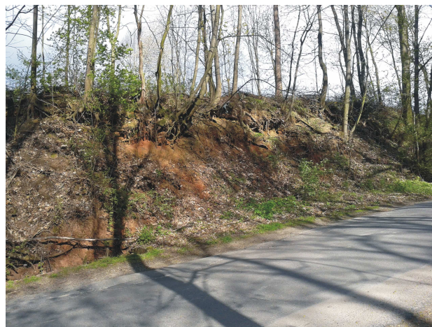
Fot. 2. Widok ogólny w rejonie dysfunkcji skarpy przy drodze powiatowej nr 3293D w Szalejewie Dolnym.
