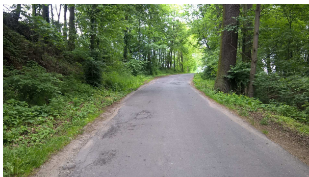
Fot. 1. Szalejów Dolny. Uszkodzona droga powiatowa nr 3293D. W asfalcie widoczne koleiny, ugięcia, pęknięcia podłużne i poprzeczne. Po lewej stronie drogi dysfunkcja skarpy. Po prawej stronie wąwóz.
