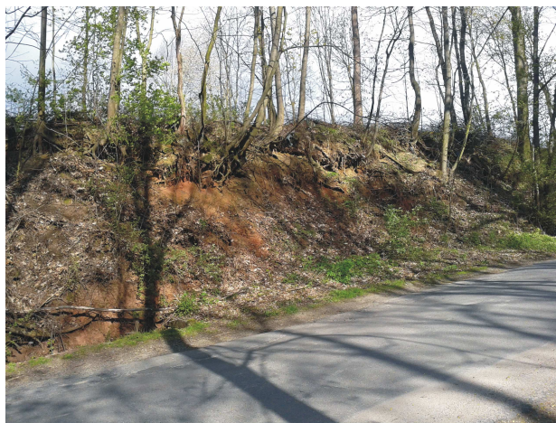
Fot. 2. Widok ogólny w rejonie dysfunkcji skarpy przy drodze powiatowej nr 3293D w Szalejewie Dolnym.
