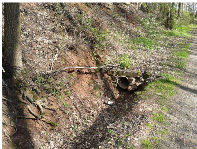
Fot. 6. Widoczny przepust D - 300 mm PHD z ujściem wody do rowu. Widoczne drzewo z odsłoniętym systemem korzeniowym.
